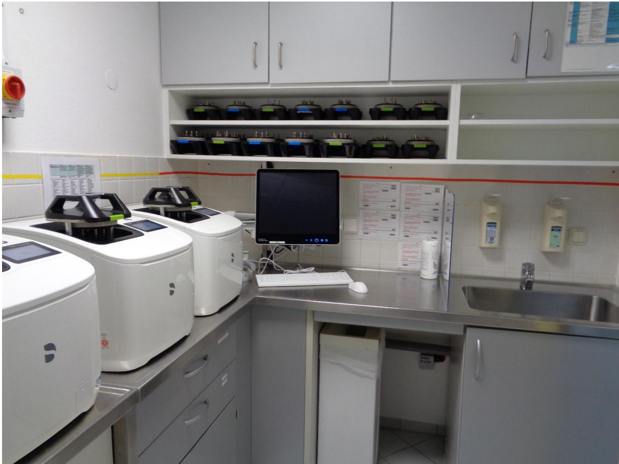
Abbildung 15: Aufbereitungsraum mit Thermodesinfektoren (TLV-Bildaufnahme)
