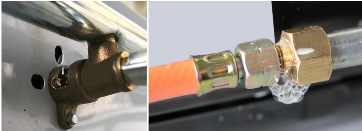
Abbildung 4 und 5: Undichte Stellen an einem Ventil und an einem Anschluss (TLV-Bildaufnahmen)
